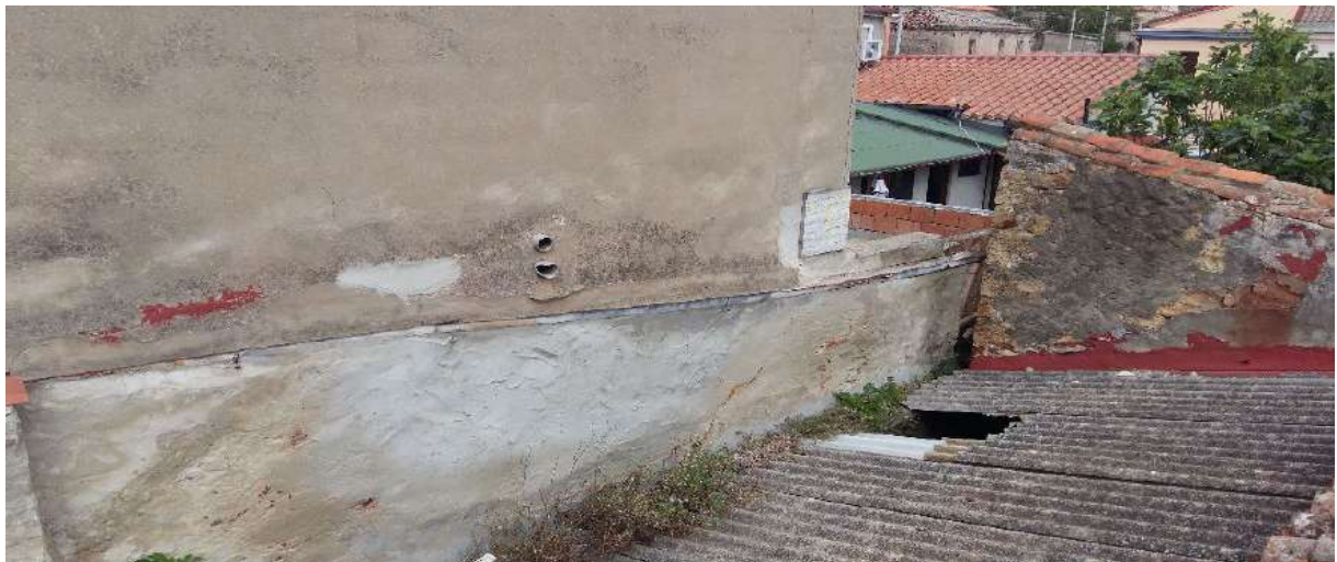
Copertura in "eternit" sopra cantina visibile vecchia gronda ancora sul muro
