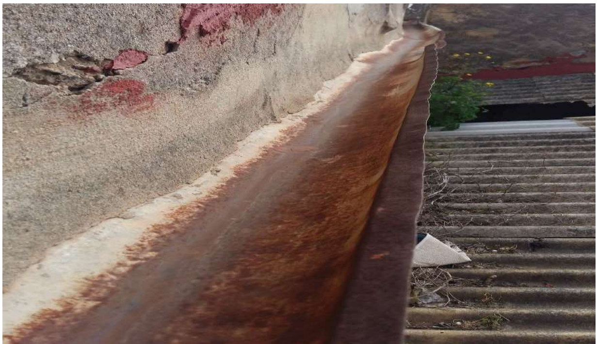
Vista della vecchia gronda ancora sul muro
