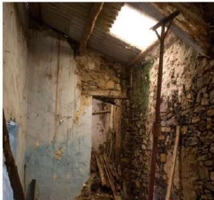
cantina con lastre in "eternit"
