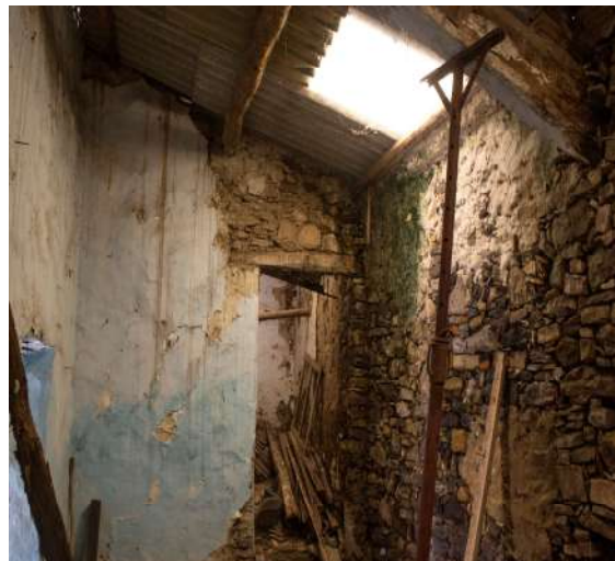
cantina con lastre in “eternit”
